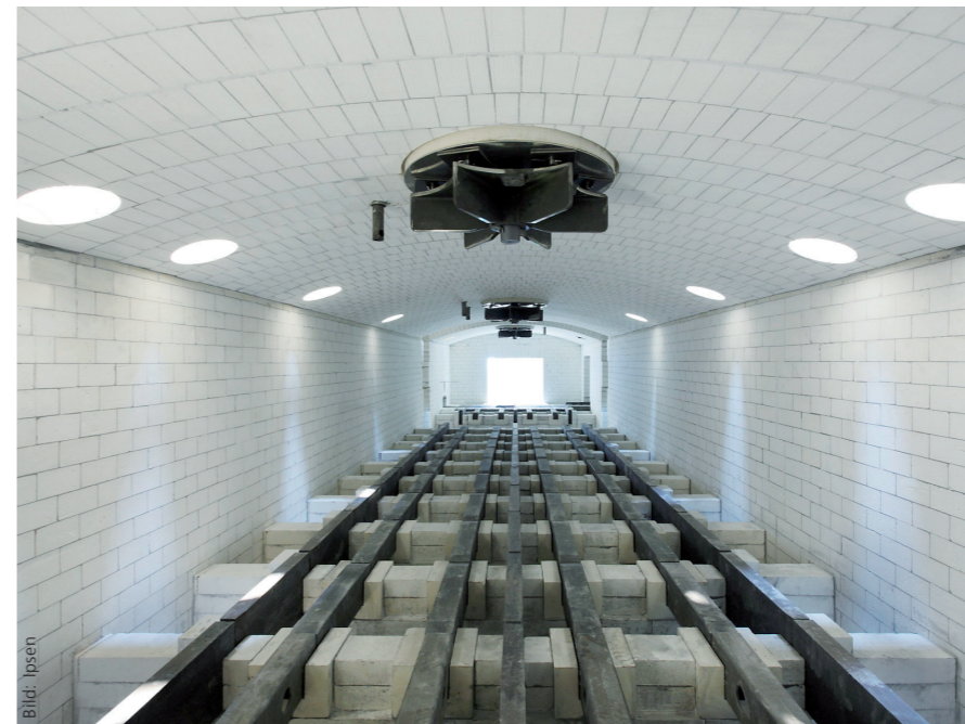
Heizkammer eines doppelbahnigen Ipsen-Nitrier-Durchstoßofens.
